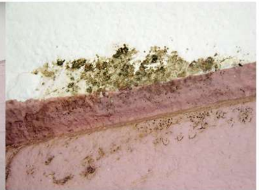
Fig. 27_Det. de mohos en pared del dormit. ppal. (M1) Fuente: fotografía tomada por la autora
