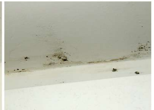
Fig. 24_Det. mohos sobre AA en dorm. ppal. Fuente: fotografía tomada por la autora
