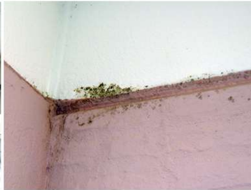
Fig. 19_Det. de mohos en buña de pared Fuente: fotografía tomada por la autora
