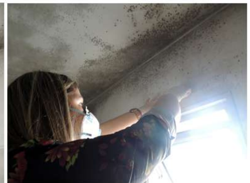
Fig. 32_Toma de muestra con cinta en cielorraso de baño (M2) Fuente: imagen propia de la autora
