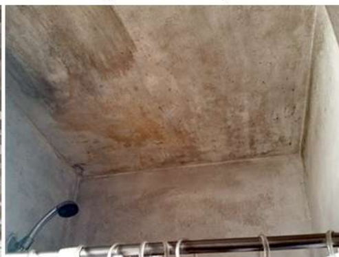
Fig. 29_Cielorraso del baño Fuente: fotografía tomada por la autora
