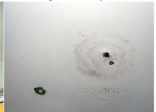
Fig. 25_Det. mohos en cielorraso del baño Fuente: fotografía tomada por la autora
