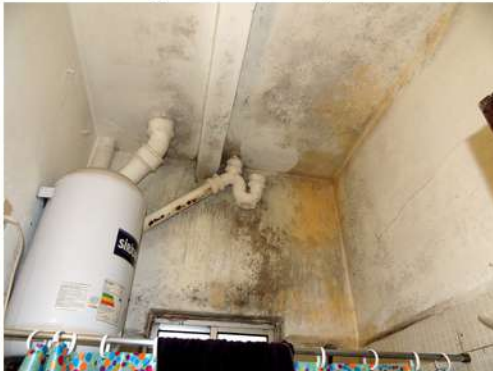
Fig. 25_Cielorraso y pared ext. del baño Fuente: fotografía tomada por la autora
