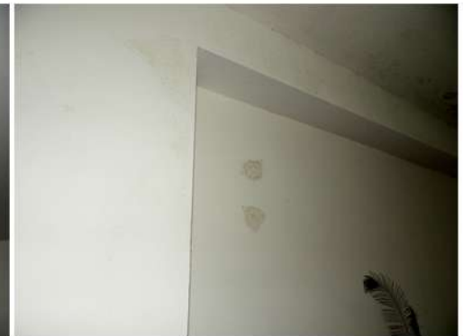
Fig. 21_Det. mohos en pared interior Fuente: fotografía tomada por la autora
