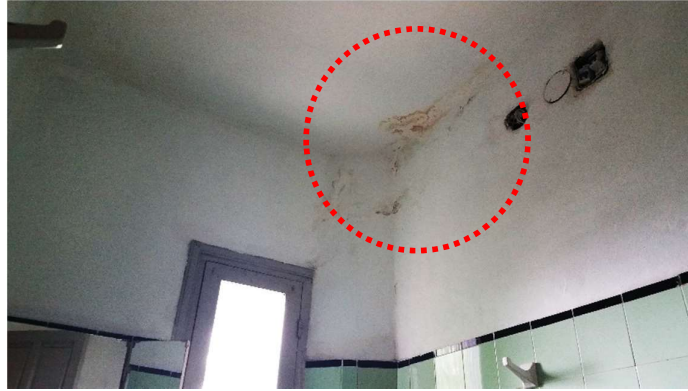
Figura 37: Humedad de filtración por fallo en impermeabilización en azotea. Vivienda en Montevideo.
