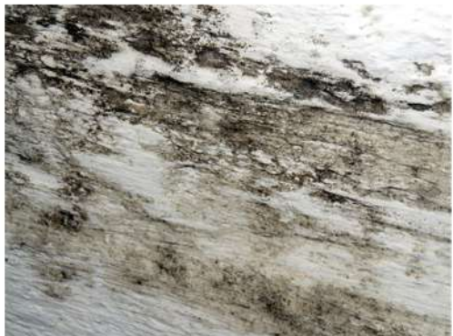
Fig. 32 Det. de antepecho enmohecido en dormit. sec. (M1) Fuente: fotografía tomada por la autora
