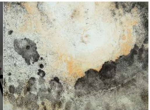
Fig. 32_Det. de mohos en cielorraso de estar-comedor (M1) Fuente: fotografía tomada por la autora
