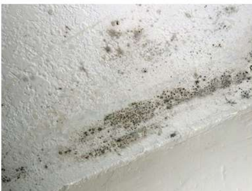
Fig. 32_Detalle de cielorraso del dormit. ppal. (M2) Fuente: fotografía tomada por la autora
