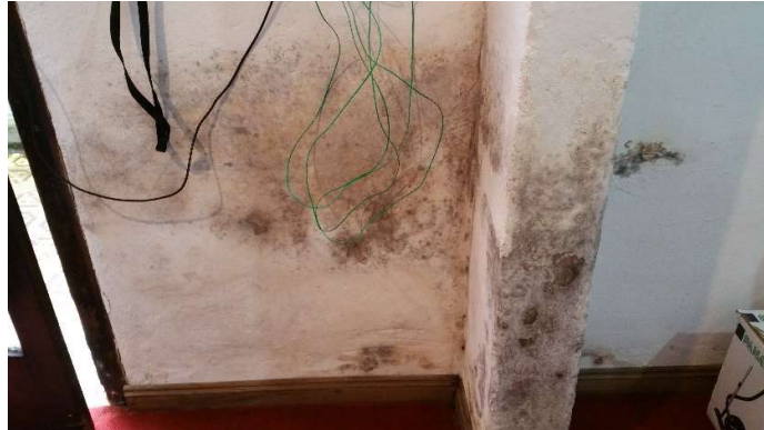
Figura 34: Humedad capilar - con proliferación de mohos-. Vivienda en Montevideo.
