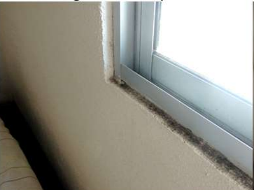
Fig. 24_Detalle mohos en revest. interior Fuente: fotografía tomada por la autora
