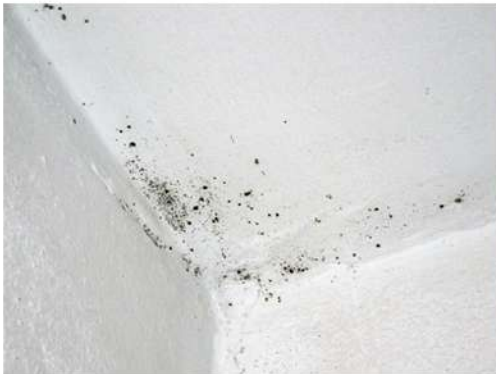
Fig. 17_Det. mohos en cielorraso del baño Fuente: fotografía tomada por la autora
