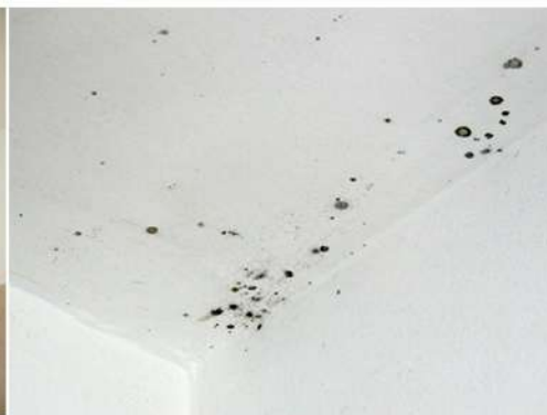
Fig. 30_Detalle de cielorraso del baño (M1) Fuente: fotografía tomada por la autora
