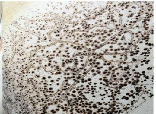
Fig. 34_Detalle de mohos en cielorraso de terraza (M2) Fuente: fotografía tomada por la autora
