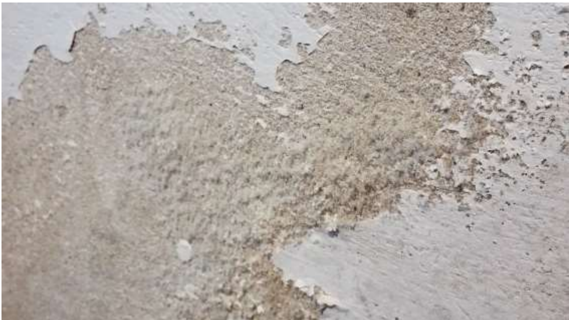
Figura 68: Eflorescencia en paño central de envolvente – Estudio de Caso n° 2
