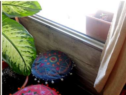
Fig. 19_Det. mohos en antepecho Fuente: fotografía tomada por la autora
