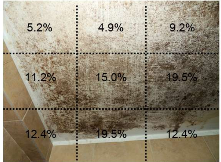
Fig. 31_Mapeo B de humedad en sector cielorraso del baño ppaal.
