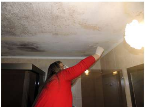
Fig. 35_Toma de muestra con hisopo esteril en cielorraso de baño Fuente: imagen propia
