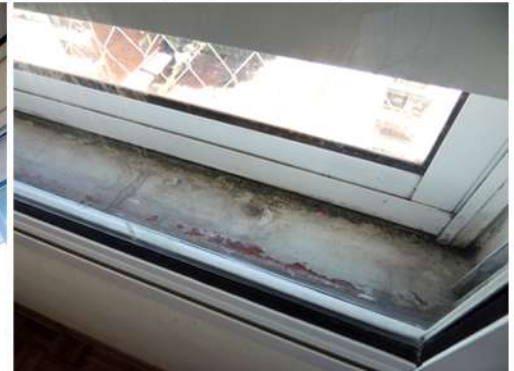
Fig. 27_Mohos en mocheta entre doble ventana en PB Fuente: fotografía tomada por la autora
