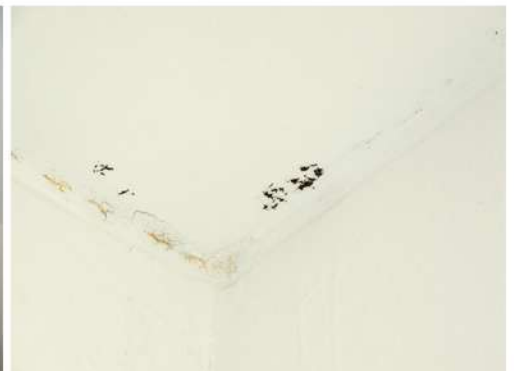
Fig. 30_Det. de mohos en cielorraso del baño (M2) Fuente: fotografía tomada por la autora
