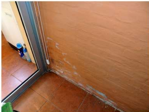
Fig. 17_Det. mohos en cocina Fuente: fotografía tomada por la autora
