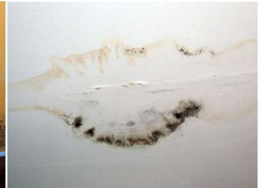
Fig. 23_Det. mohos en cielorraso estar Fuente: fotografía tomada por la autora
