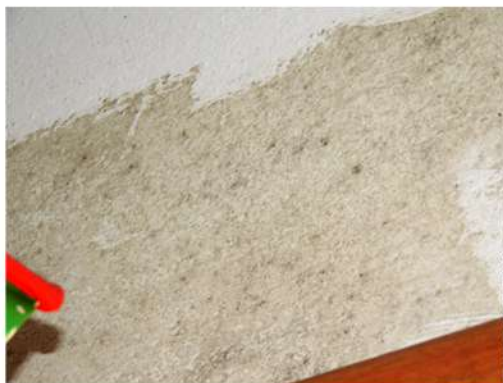
Fig. 35_Det. de mohos en dintel de dormit. sec. (M2) Fuente: fotografía tomada por la autora
