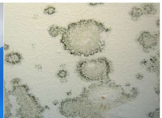
Fig. 22_Det. de mohos en cielorraso de dormit. ppal. (M1) Fuente: fotografía tomada por la autora
