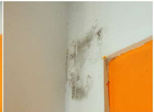
Fig. 20_Det. mohos en punto singular Fuente: fotografía tomada por la autora
