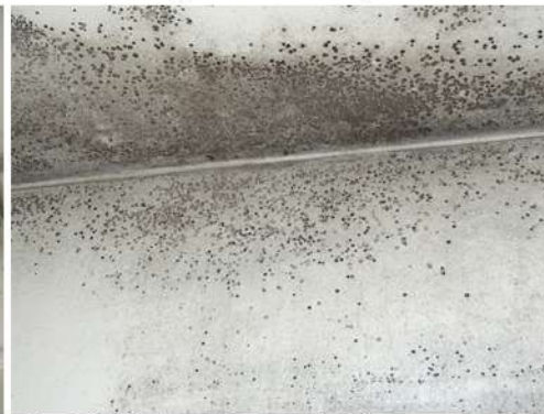
Fig. 23_Det. mohos en baño Fuente: fotografía tomada por la autora
