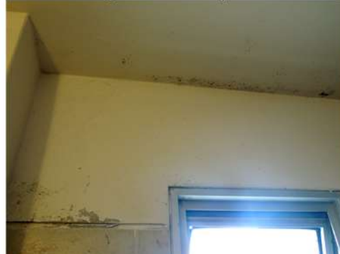
Fig. 25_Cielorraso del baño Fuente: fotografía tomada por la autora
