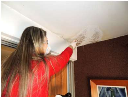
Fig. 32_Toma de muestra con hisopo estéril en cielorraso de terraza Fuente: imagen propia
