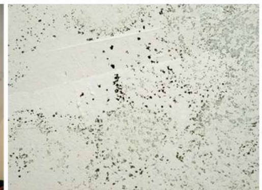
Fig. 35_Det. de mohos en cielorraso de dormit. ppal. (M2) Fuente: fotografía tomada por la autora
