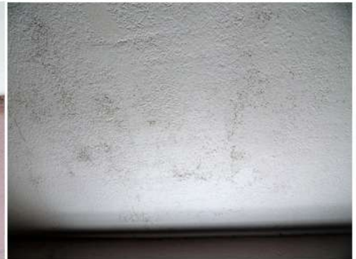
Fig. 20_Cielorraso enmohecido Fuente: fotografía tomada por la autora
