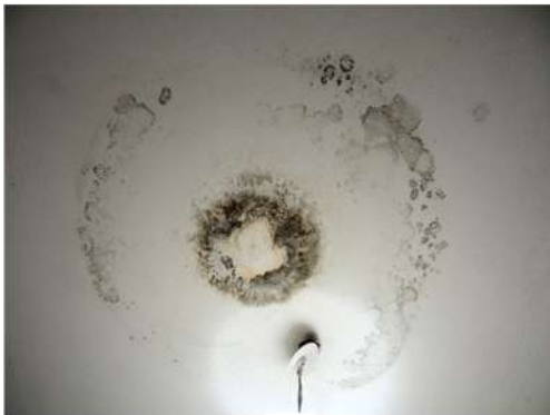
Fig. 19_Det. mohos en cielorraso estar Fuente: fotografía tomada por la autora
