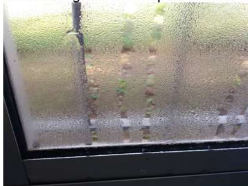
Fig. 27_Det. de abertura con condensación en cocina Fuente: fotografía tomada por la autora
