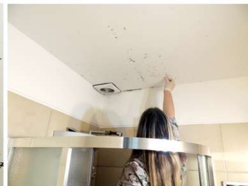
Fig. 37_Toma de muestra con hisopo estéril en cielorraso del baño Fuente: imagen propia de la autora
