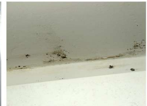
Fig. 34_Det. del cielorraso del dormit. ppal. sobre AA (M1) Fuente: fotografía tomada por la autora
