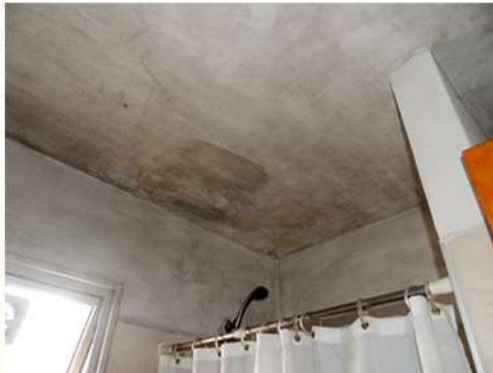
Fig. 23_Cielorraso del baño Fuente: fotografía tomada por la autora
