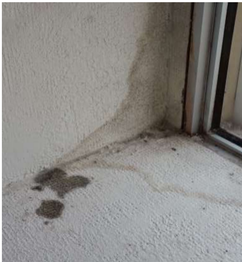
Figura 67: Filtración de agua de lluvia a través de abertura, con proliferación en antepaño de terminación texturada – Estudio de Caso n° 1
