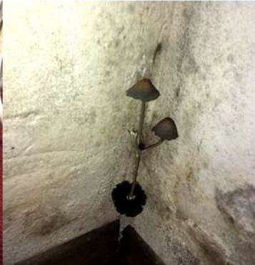
Fig. 28_Setas creciendo en diedro inferior en dormitorio principal Fuente: fotografía tomada por la autora
