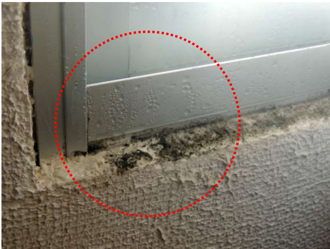
Figura 66: Condensaciones superficiales en abertura de aluminio con escorrentía en antepecho – Estudio de Caso n° 15
