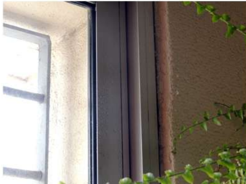
Fig. 21_Det. marco abertura condensado Fuente: fotografía tomada por la autora
