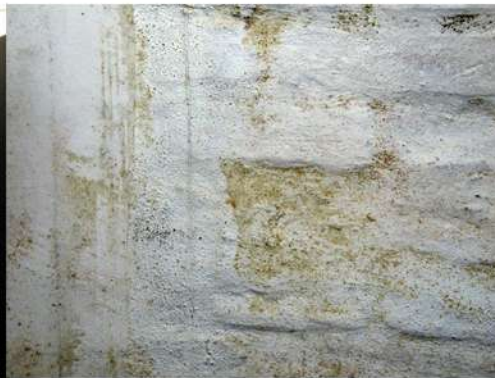
Fig. 23_Detalle de antepecho con mohos Fuente: fotografía tomada por la autora
