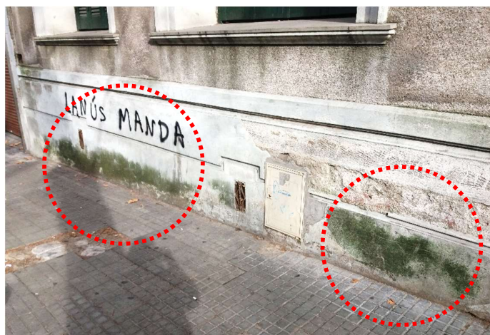
Figura 36: Humedad capilar – biodeterioro a nivel de zócalo exterior -. Vivienda en Montevideo.
