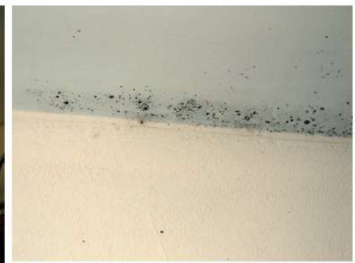
Fig. 34 Det. del cielorraso del baño (M2) Fuente: fotografía tomada por la autora
