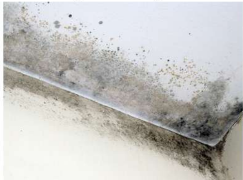
Fig. 25_Detalle de mohos en triedro de pasillo en PA Fuente: fotografía tomada por la autora
