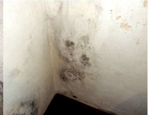
Fig. 29_Diedro inferior de dormitorio principal Fuente: fotografía tomada por la autora
