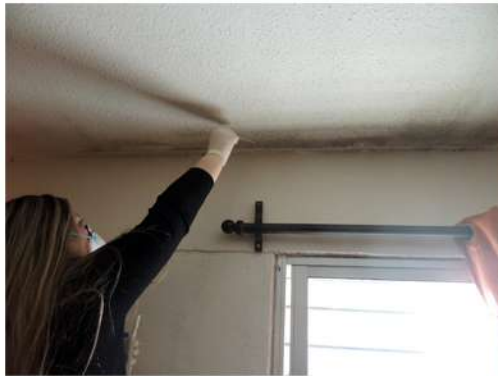
Fig. 28_Toma de muestra con hisopo estéril en cielorraso de estar-comedor (M1) Fuente: imagen propia de la autora
