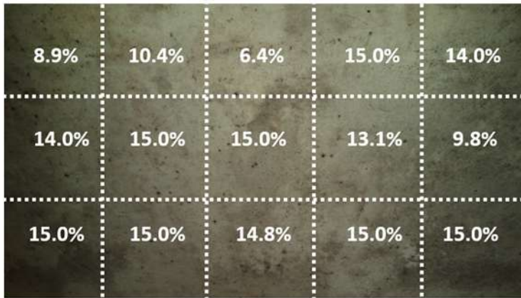
Fig. 31_Mapeo A de humedad en sector cielorraso de lavadero Fuente: Elaboración propia
