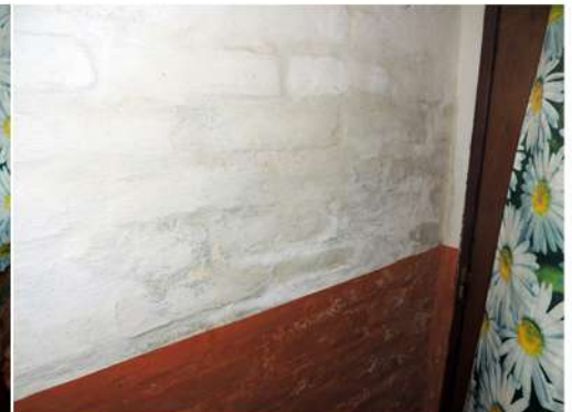
Fig. 19_Det. mohos en cocina Fuente: fotografía tomada por la autora
