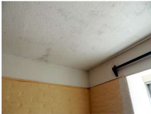
Fig. 18_Det. mohos en cielorraso Fuente: fotografía tomada por la autora
