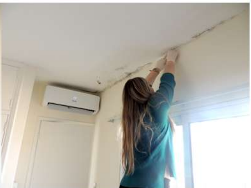
Fig. 35_Toma de muestra con cinta en cielorraso de estar de PA Fuente: imagen propia
