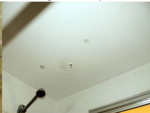
Fig. 24_Cielorraso del baño Fuente: fotografía tomada por la autora
