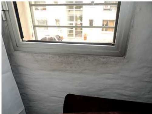
Fig. 18_Det. mohos en antepecho Fuente: fotografía tomada por la autora
