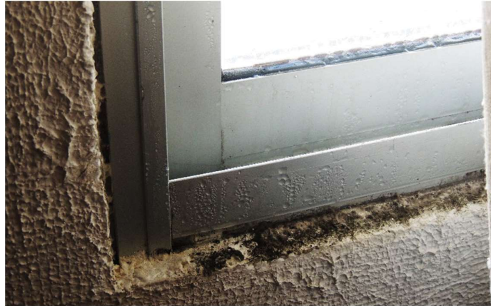
Figura 43: Condensación en carpintería metálica de abertura. Vivienda en Montevideo.
