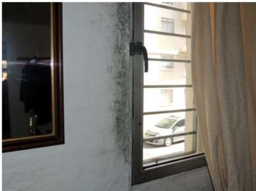
Fig. 18_Det. mohos en jamba de abert. Fuente: fotografía tomada por la autora
