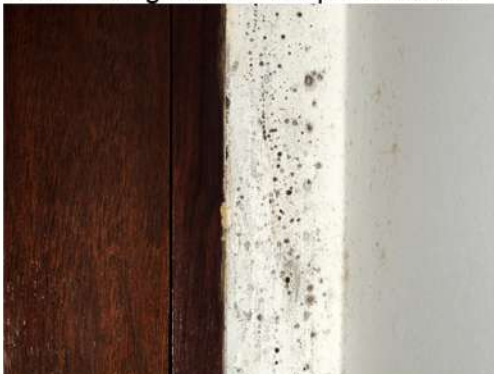
Fig. 24_Det. mohos en moqueta de puerta Fuente: fotografía tomada por la autora
