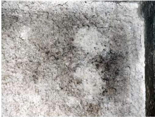
Fig. 36_Det. de mohos en dormit. sec.(M1) Fuente: fotografía tomada por la autora
