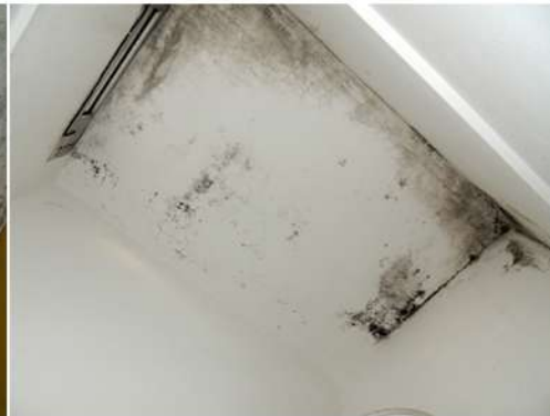
Fig. 22_Cielorraso del baño Fuente: fotografía tomada por la autora
