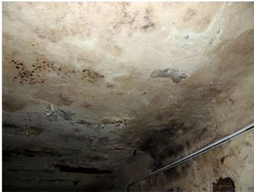
Fig. 22_Det. de cielorraso con cond. sup. en oficina clausurada de PA Fuente: fotografía tomada por la autora
