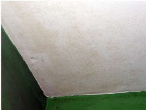
Fig. 22_Det. mohos en cielorraso domi. ppal. Fuente: fotografía tomada por la autora
