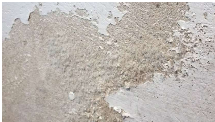
Figura 46: Eflorescencias salinas causadas por condensaciones en el interior del muro. Vivienda en Montevideo.
