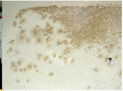
Fig. 41_Detalle de mohos en pared de oficina de PA (M5) Fuente: fotografía tomada por la autora
