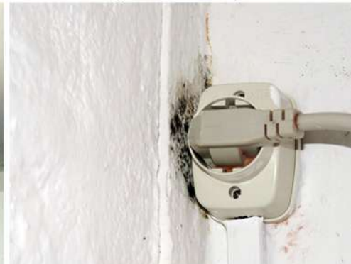
Fig. 26_Det. mohos en tomacorriente de AA Fuente: fotografía tomada por la autora
