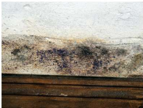
Fig. 35_Detalle de mohos en zócalo de dormitorio ppal (M8) Fuente: fotografía tomada por la autora
