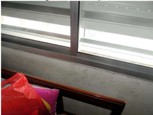
Fig. 25_Det. mohos en antepecho Fuente: fotografía tomada por la autora
