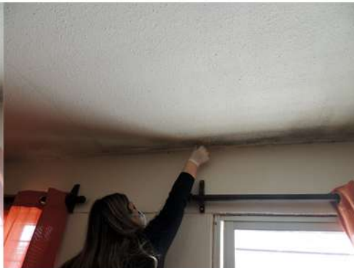
Fig. 29_Toma de muestra con cinta en cielorraso de estar-comedor (M1) Fuente: imagen propia de la autora
