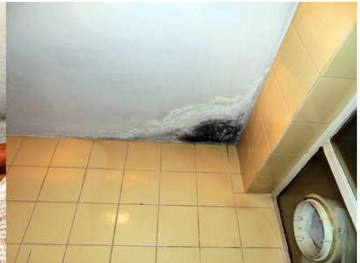
Fig. 23_Cielorraso de lavadero Fuente: fotografía tomada por la autora
