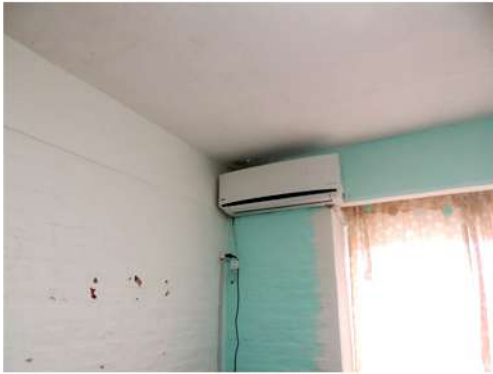
Fig. 19_Patología sobre AA en dormi. sec. Fuente: fotografía tomada por la autora
