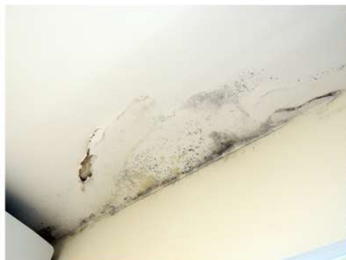
Fig. 22_Cielorraso enmohecido en PA Fuente: fotografía tomada por la autora
