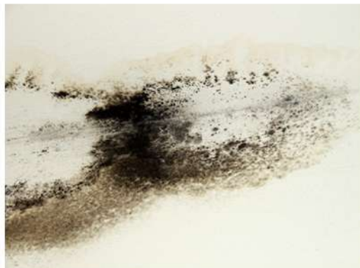
Fig. 35_Det. de mohos en cielorraso de estar-comedor (M3) Fuente: fotografía tomada por la autora
