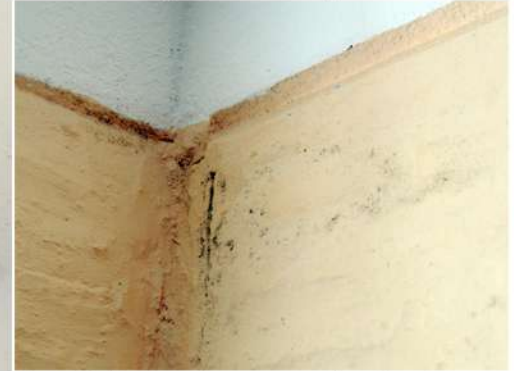
Fig. 23_Det. mohos en punto singular Fuente: fotografía tomada por la autora
