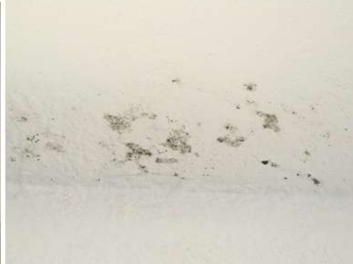
Fig. 22_Det. mohos en baño Fuente: fotografía tomada por la autora
