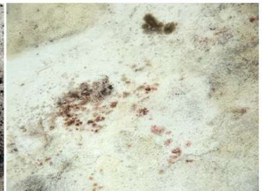
Fig. 37_Detalle de mohos en dintel de dormitorio secundario (M12) Fuente: fotografía tomada por la autora
