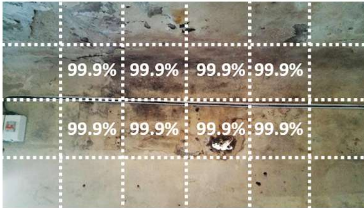
Fig. 31_Mapeo A de humedad en sector pared de oficina clausurada en PA Fuente: Elaboración propia
