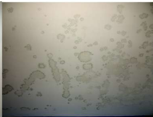
Fig. 17_Det. mohos en cielorraso Fuente: fotografía tomada por la autora
