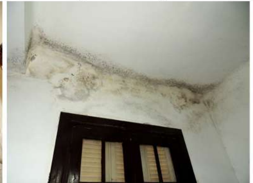
Fig. 26_Cielorraso de dormi. secundario Fuente: fotografía tomada por la autora
