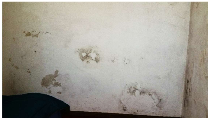
Figura 45: Mohos en paño central de pared orientada al sur-este. Vivienda en Montevideo.
