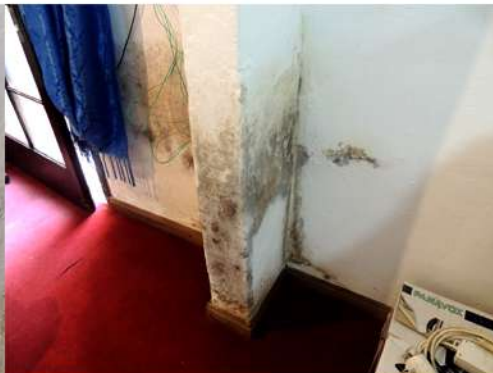
Fig. 22_Pared hacia patio en dormi. ppal Fuente: fotografía tomada por la autora
