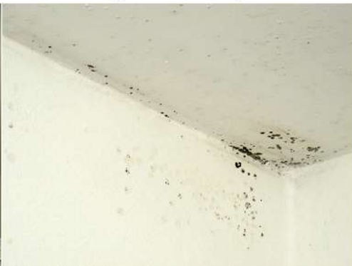
Fig. 23_Det. mohos en baño Fuente: fotografía tomada por la autora
