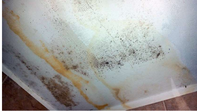
Figura 39: Humedad accidental por rotura de cañerías en el baño del piso contiguo. Vivienda en Montevideo.
