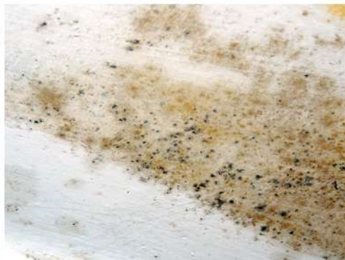
Fig. 36_Detalle de mohos en cielorraso del baño (M6) Fuente: fotografía tomada por la autora
