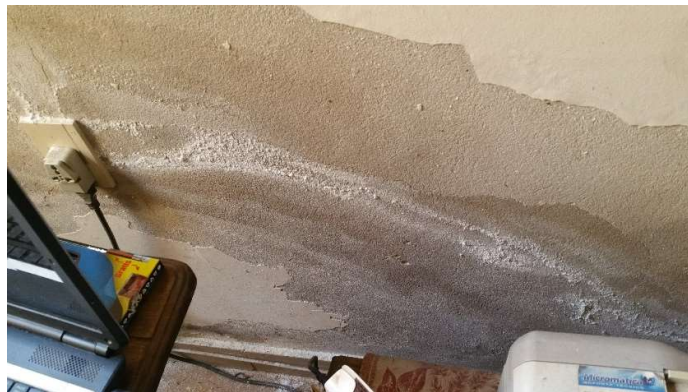
Figura 35: Humedad capilar – vista de las sales por eflorescencias-. Vivienda en Montevideo.
