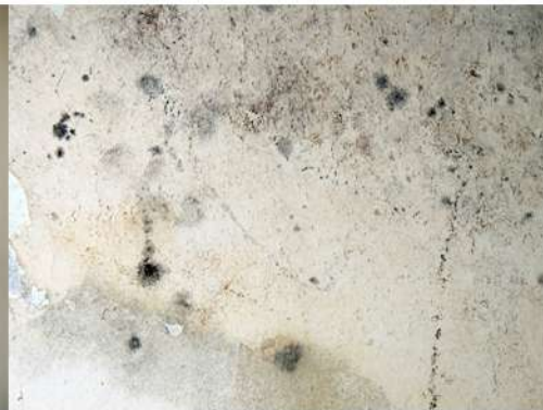
Fig. 34_Detalle de pared con mohos en sala de reuniones (M9) Fuente: fotografía tomada por la autora
