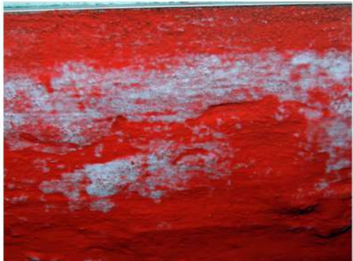
Fig. 21_Det. mohos en antepecho Fuente: fotografía tomada por la autora
