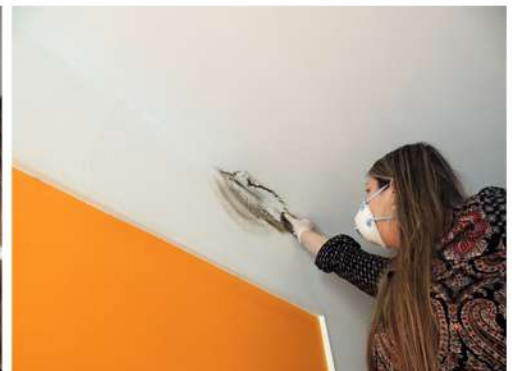
Fig. 34 Toma de muestra con cinta en cielorraso de estar-comedor (M3) Fuente: imagen propia de la autora
