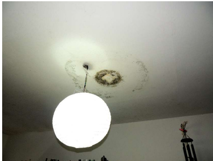
Figura 38: Humedad de filtración por fallo en impermeabilización en azotea. Vivienda en Montevideo.
