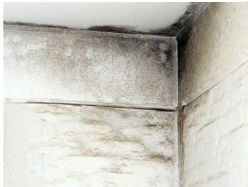
Fig. 19_Det. mohos en triedro superior Fuente: fotografía tomada por la autora
