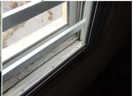
Fig. 24_Det. mohos entre doble ventana Fuente: fotografía tomada por la autora
