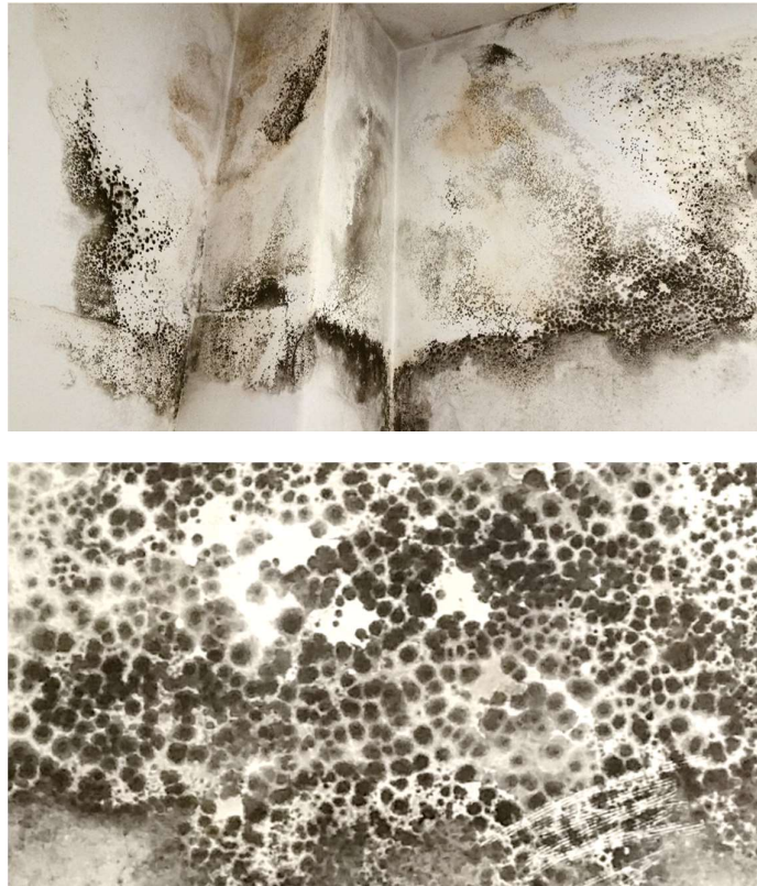
Figura 40: Humedad accidental por rotura de montante de agua potable con la consecuente inundación del ducto. Vivienda en Montevideo.
