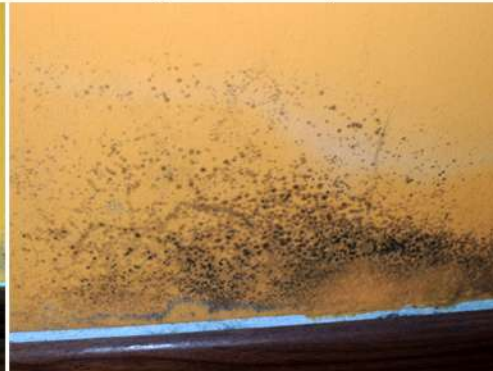
Fig. 22_Det. mohos a nivel de zócalo Fuente: fotografía tomada por la autora
