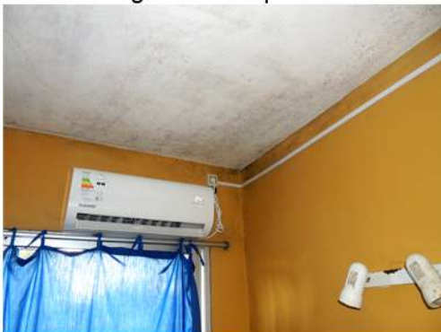
Fig. 9_Det. del aire acond. en consultorio Fuente: imagen tomada por la autora
