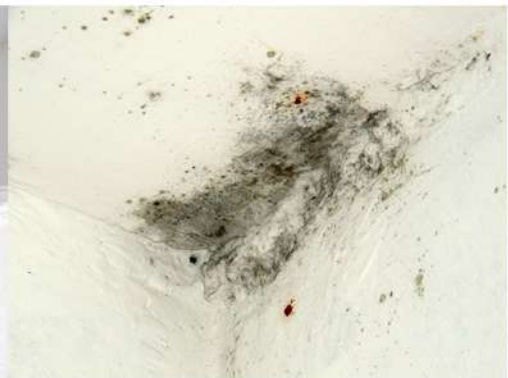
Fig. 31 Det. de cielorraso del dormit. ppal. (M1) Fuente: fotografía tomada por la autora
