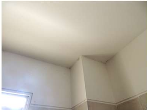
Fig. 21_Cielorraso del baño Fuente: fotografía tomada por la autora
