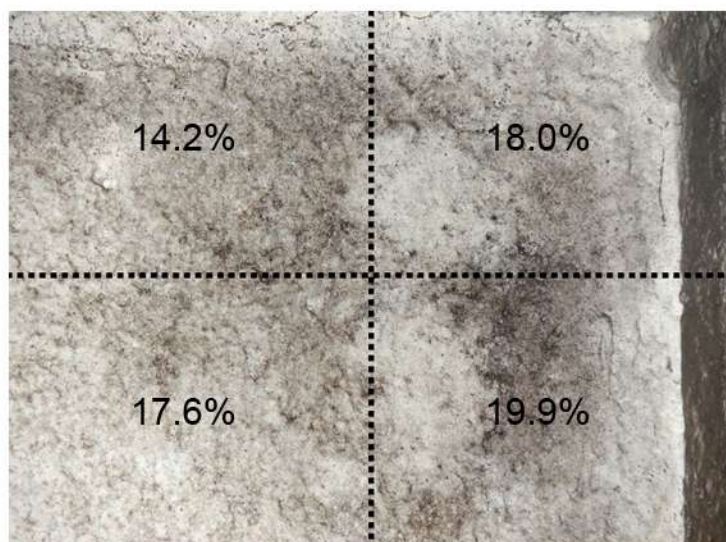
Fig. 29_Mapeo B de humedad en sector pared del dormitorio principal
