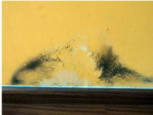
Fig. 21_Det. mohos a nivel de zócalo Fuente: fotografía tomada por la autora
