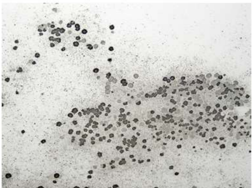
Fig. 33_Det. de mohos en dintel en el baño (M2) Fuente: fotografía tomada por la autora
