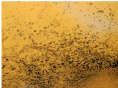
Fig. 32 Det. de mohos en zócalo de estar-comedor (M2) Fuente: fotografía tomada por la autora
