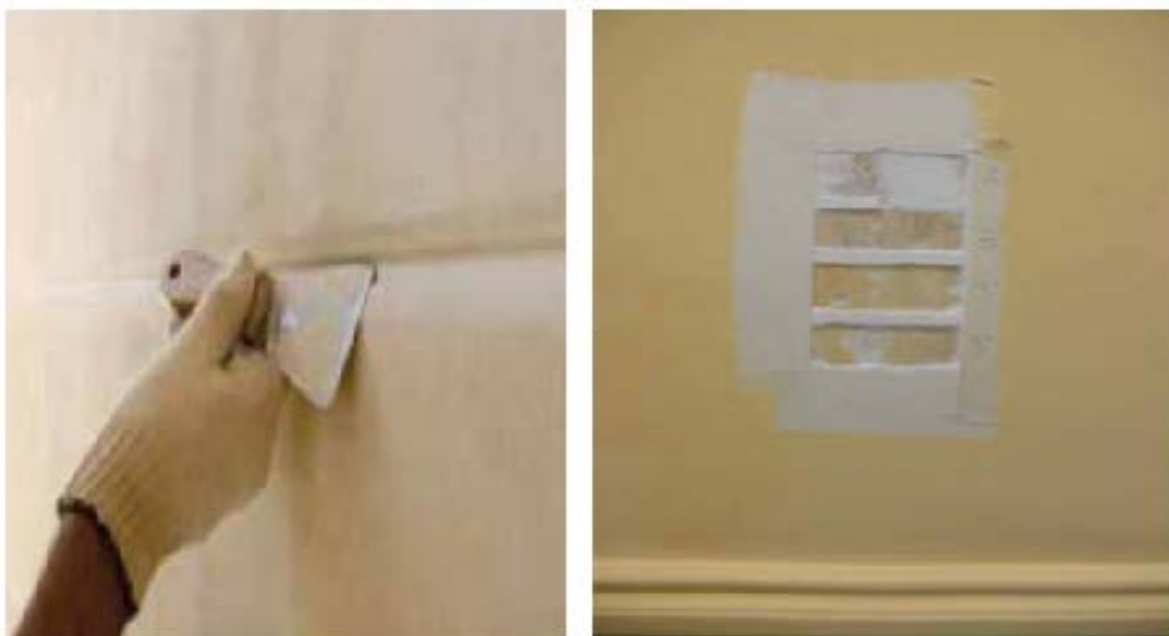
Fig. N°42 y 43.- Aplicación del nuevo Símil piedra y cateos de color en muros interiores
