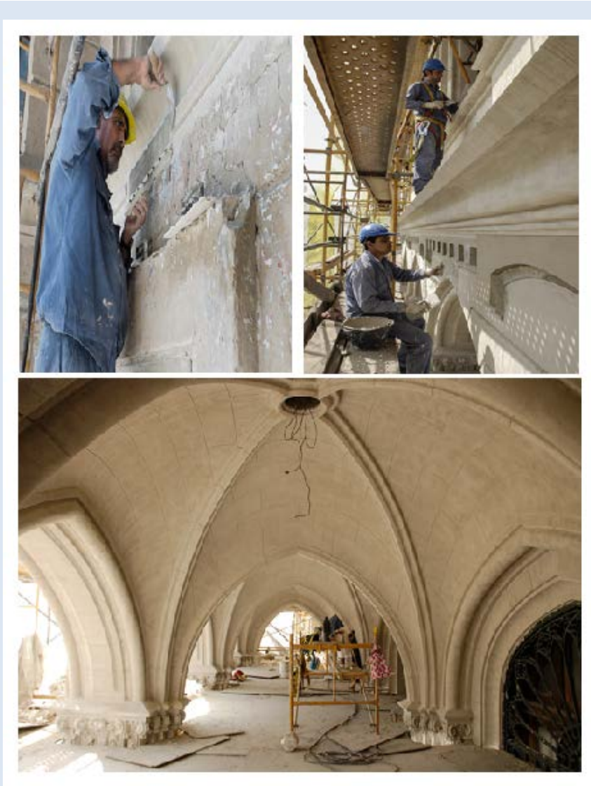
Fig. N° 44, 45 y 46.- Imágenes de los trabajos de intervención edilicia en revoques y cúpula de acceso al edificio de Paseo Colón 922. (Fotografías tomadas por la empresa CONSULPER S.A.)- Año 2012
