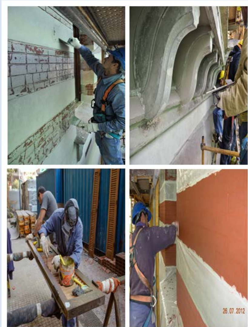
Fig. N° 49 a 52.- Trabajos varios durante la intervención edilicia en muros, mansardas y carpinterías. (Fotografías a color tomadas por la empresa Consulper S.A.- Año 2012).
