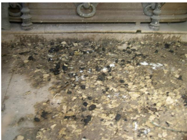
Figura 22. Biodeterioro físico. Excremento de animales en el interior de una bóveda.
