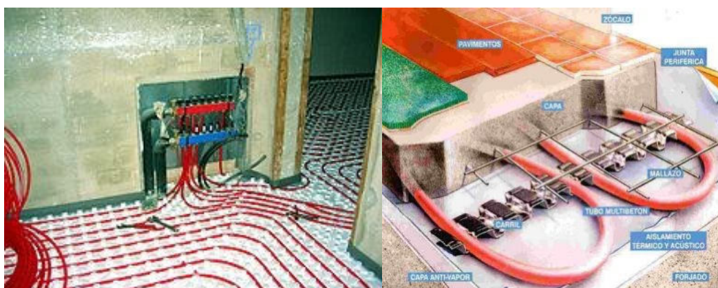
Figura 78. Instalación de las conducciones: contrapiso radiante en soporte especial a la izquierda y losa estructural radiante a la derecha.
