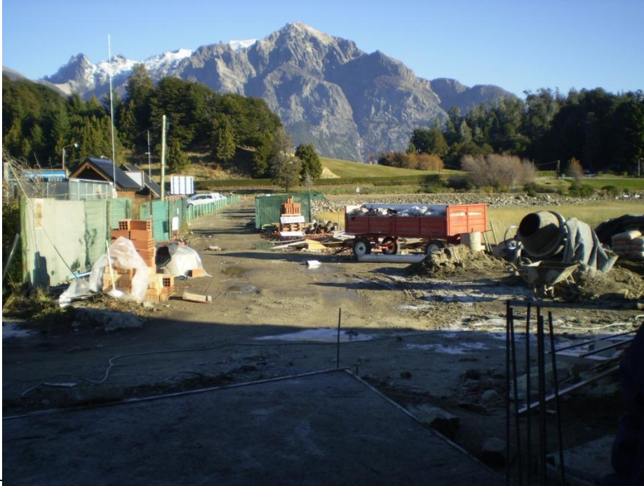
Foto 2: ingreso a la obra por único camino, el cual está vallado por parantes de madera, malla sima y media sombra verde.
