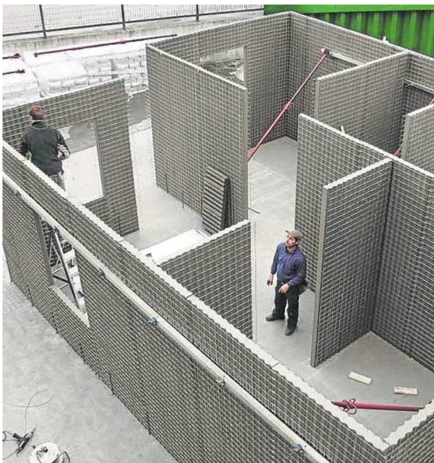
Figura 24. Proceso constructivo de una vivienda utilizando el sistema constructivo 3D panel. Fuente: http://noticias.arq.com.mx/Detailles/17370.html#.WR9T1Wg1-M8
