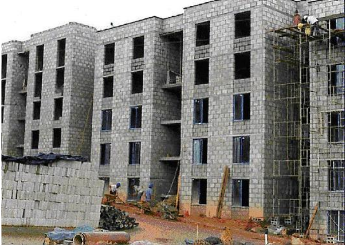
Figura 20. Conjunto habitacional VIS desarrollado con mampostería reforzada en bloque de concreto. Fuente: http://materialesdeconstruccion.blogspot.com.ar/2012/10/mamposteria-estructural.html
