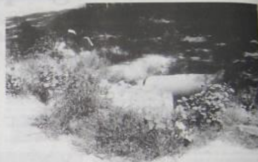
Estado en que se encuentran los tubos y las cunetas: completamente tapados
