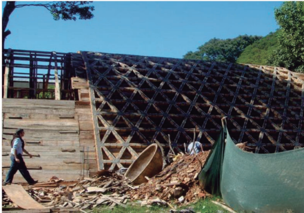
-La bóveda de ladrillo aligerado, para poder ser levantado necesita un encofrado de madera hasta que el mortero fragüe y alcance un resistencia optima.
