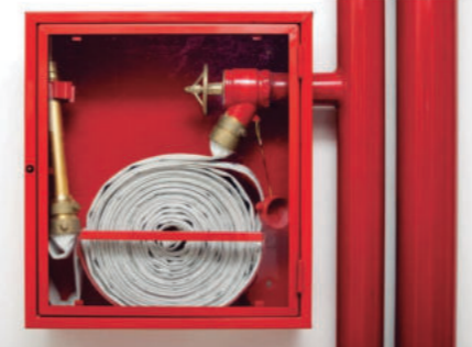
BIE (boca de incendio equipada)
