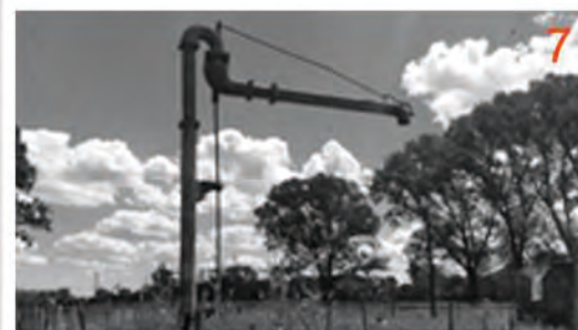
TOMA DE AGUA
