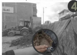
4 Hormigón pobre que hace de base limpia y nivelada para realizar la armadura de hierro de las fundaciones y tabiques según cálculos.
