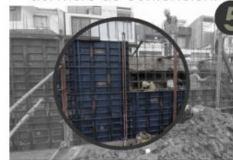
5 Se hormigona las fundaciones y una vez que adquiere resistencia se realiza el encofrado de los tabiques .
