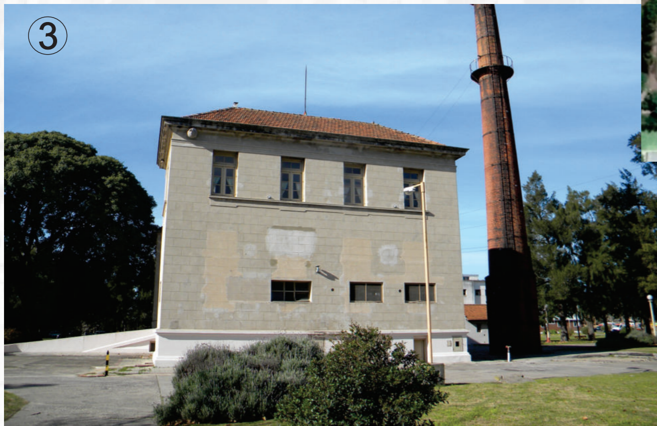
En la foto 3 se observa el lado del pabellón 6 que se unirá a los pabellones 1 y 2
