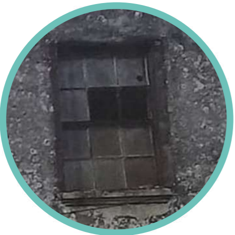
Carpinterías totalmente en abandonos
