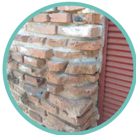
Mampostería de ladrillo común, en estado de abandono.
