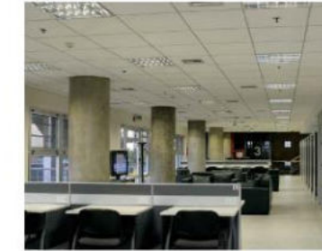
Luminaria empotrada en techo distribuida en cielaraso, armoniosamente con los demás elementos que conviven en el (rejillas de inyección/extracción, rociadores, detectores, etc)
