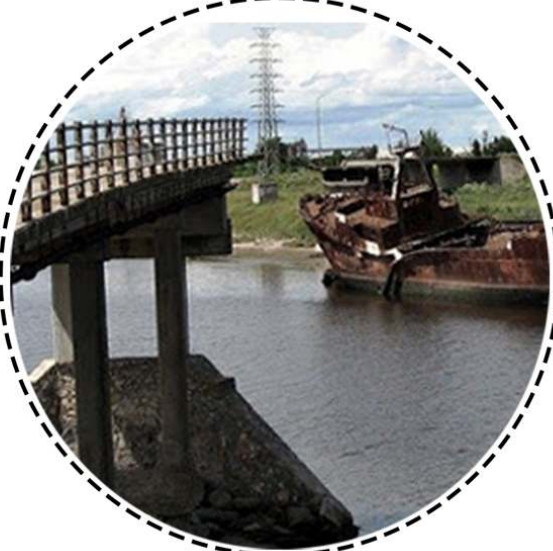
5 Estado actual de las ruinas del puente.
