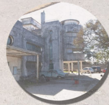
Gran deterioro de la fachada
