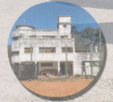
Humedad, oxido, aberturas, fisuras, etc
