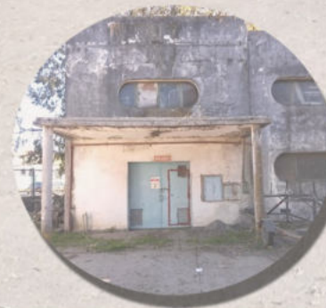
Estado de precariedad y abandono
