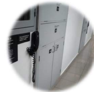
Mueble de transferencia desde el exterior del box
