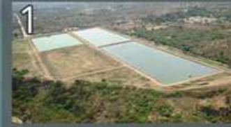
1 Planta de tratamiento de efluentes con doble cordón arbolado
