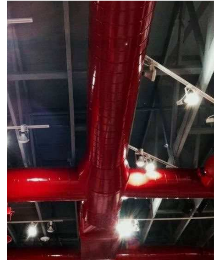
Conductos circulares a la vista en el edificio Preexistente para destacar su carácter industrial
