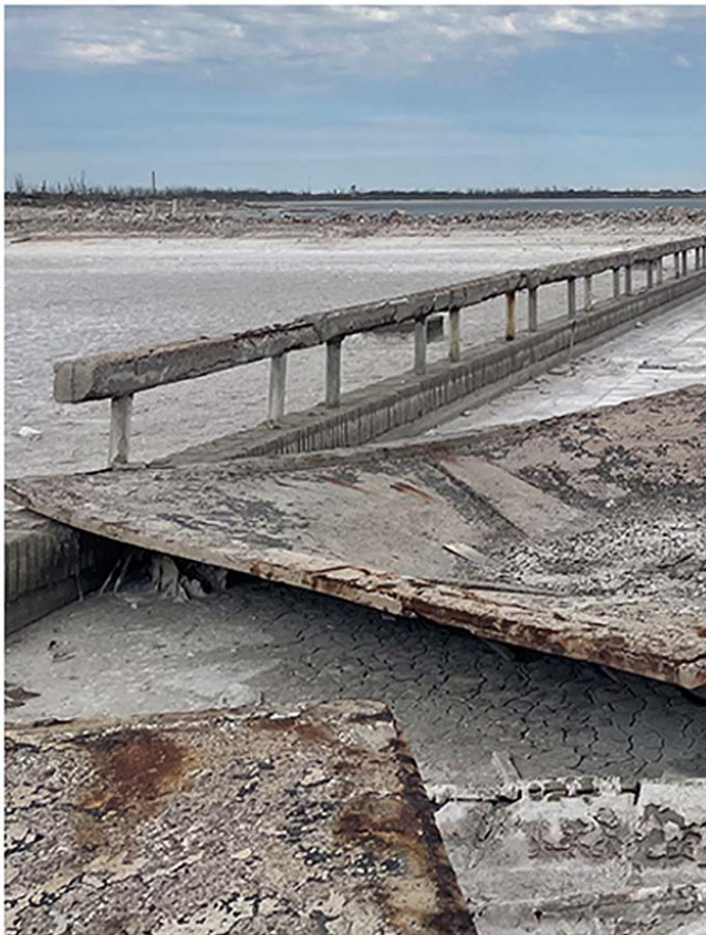
1. Las barandas de borde del sector de la pileta.
