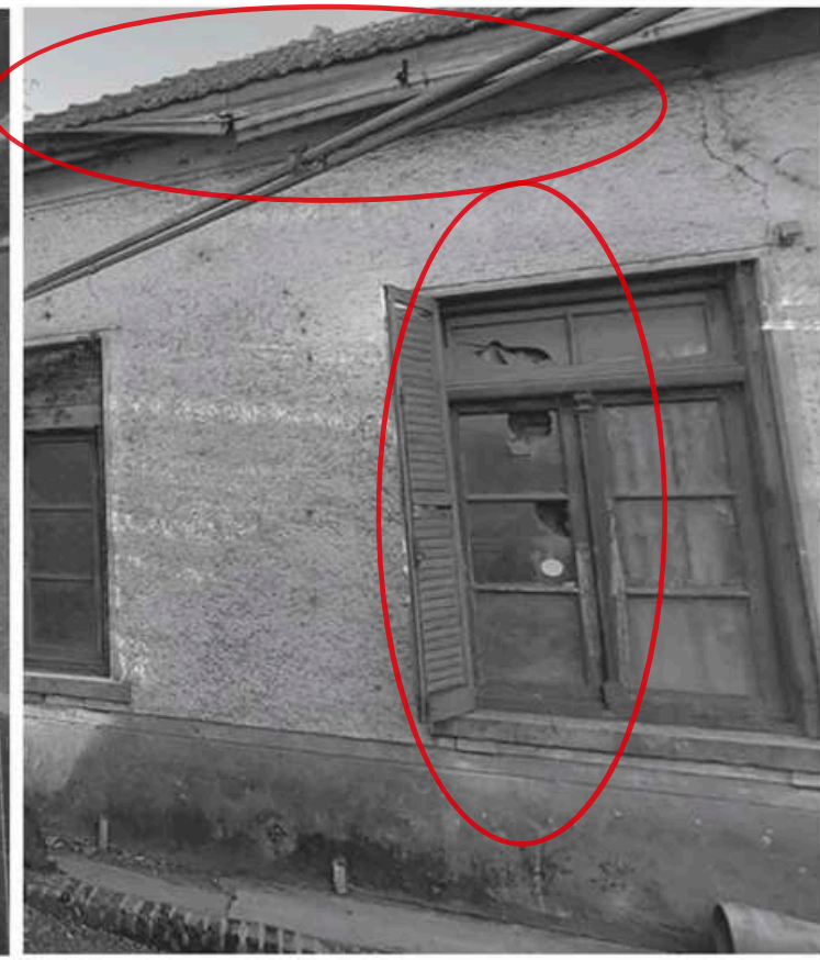
Vidrios y canaletas rotas
