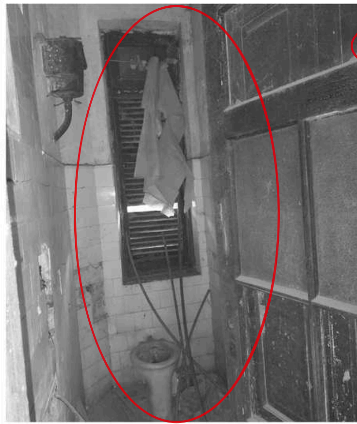
Baños sin mantenimiento
