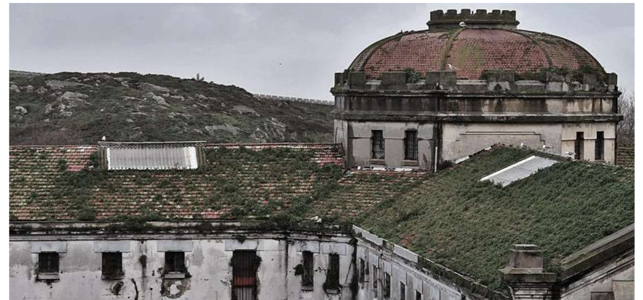
imagen del estado de deterioro de las cubiertas
