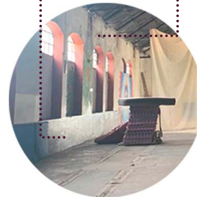
GRIETAS Y FISURAS
