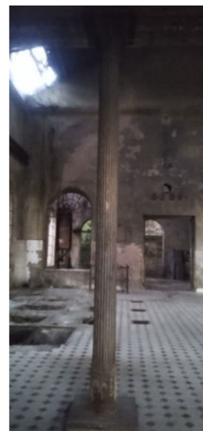
(La sala de maquinas necesita restaurar el piso y limpiar el subsuelo)
