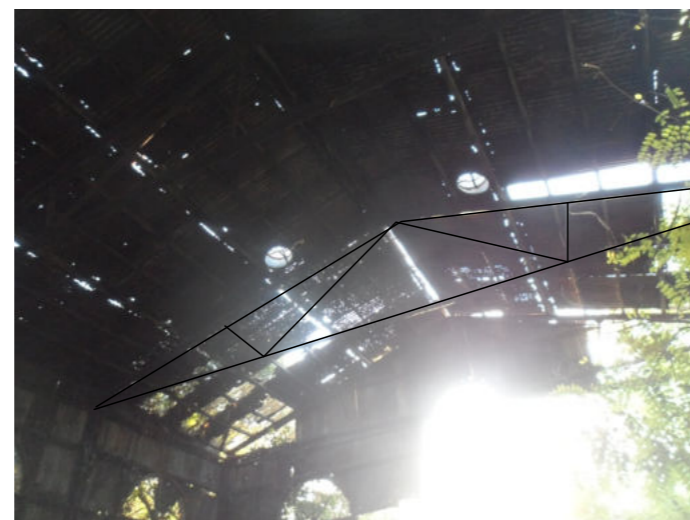
(En esta imagen podemos apreciar la estructura metálica y el deterioro del material del mismo por lo que se deberán realizar tareas de mantenimiento para la restauración y uso del nuevo techo).
