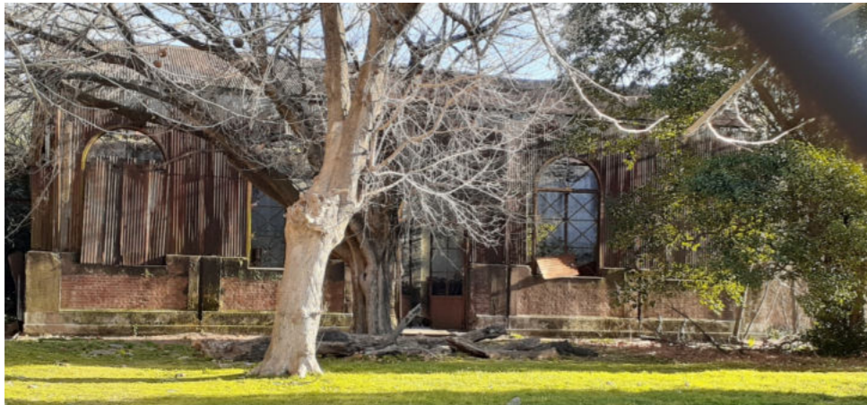
(En la fachada se aprecia el paso del tiempo, el deterioro de los materiales que deberán ser removidos y cambiados por nuevos para restaurar el edificio como solía ser).
