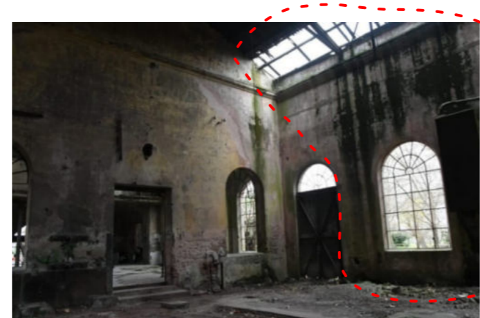
(En el interior de la sala de calderas, se puede ver la falta de techo, la humedad haciendo efecto en las paredes demostrando el paso del tiempo y el estado de abandono del lugar. Deberíamos restaurarlo completando el techo y continuando los trabajos de aislación en el edificio).
