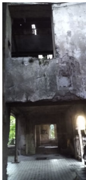
(Ingreso abandonado, necesita limpiarse y aislarse para volver a funcionar).
