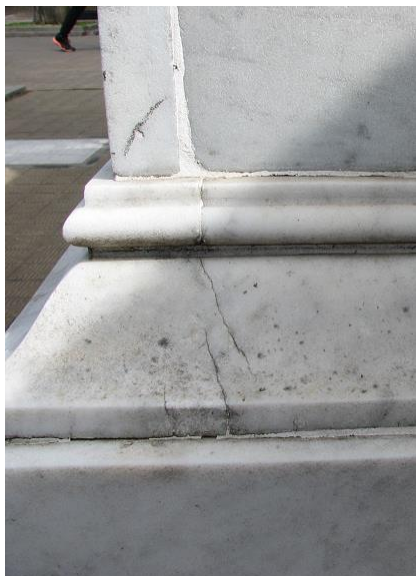
Figura 9. Monumento a Gregorio Perdriel. Fisuras superficiales. Fuente: elaboración propia.
