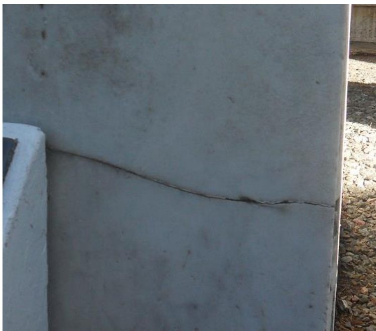
Figura 14. Monumentos a Cornelio Saavedra. Fisuras estructurales. Fuente: elaboración propia.
