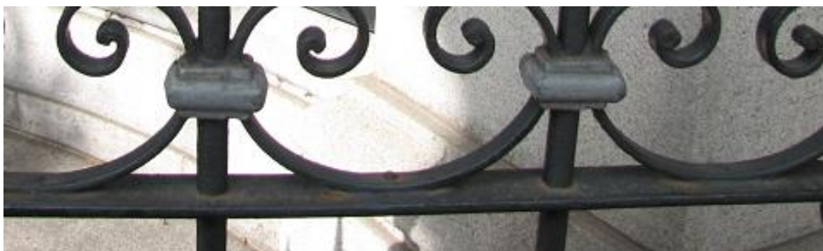
Figura 17. Monumento a Guillermo Rawson. Oxidación local. Fuente: elaboración propia.
