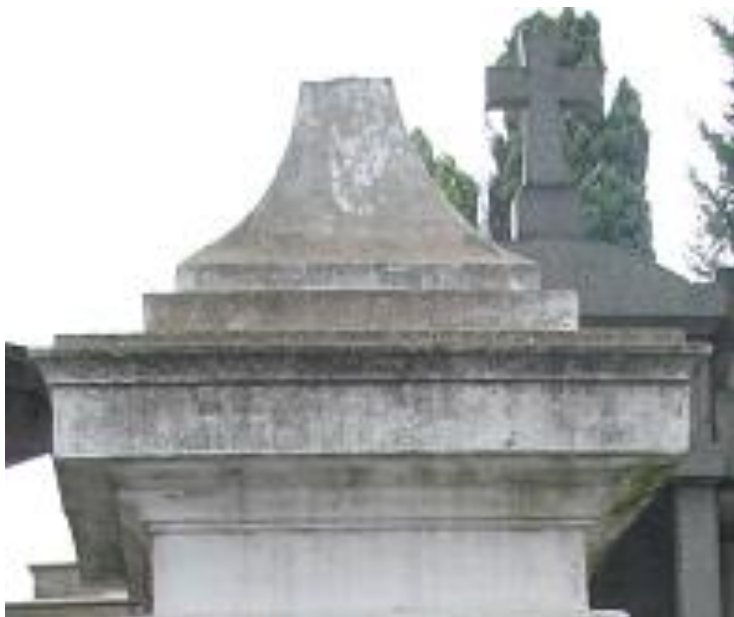
Figura 16. Monumento a Juan Izquierdo. Desprendimiento de revestimiento de pintura. Fuente: elaboración propia.
