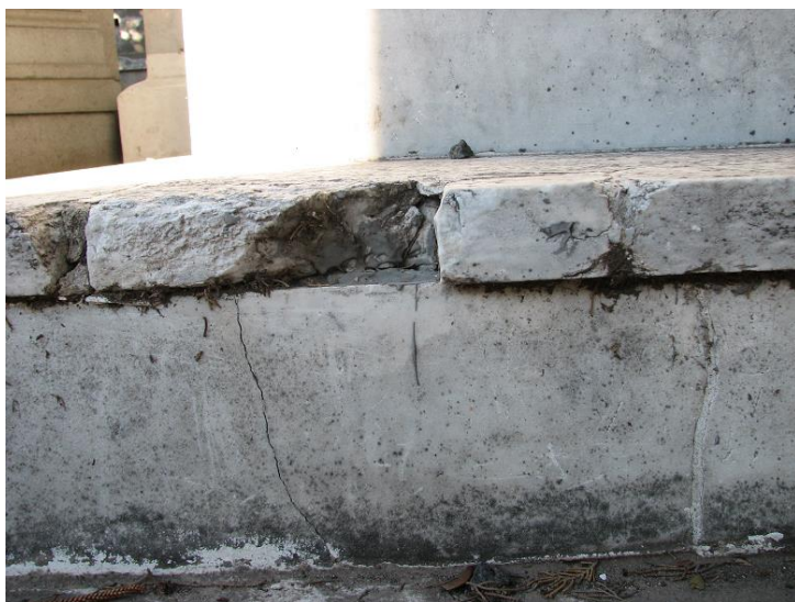
Figura 10. Monumento a Juan Andrés de la Peña. Pérdida de material. Fuente: elaboración propia.
