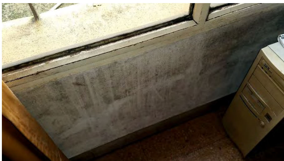
Figura 21: moho en antepecho de pared orientación sur. Vivienda en Montevideo.
