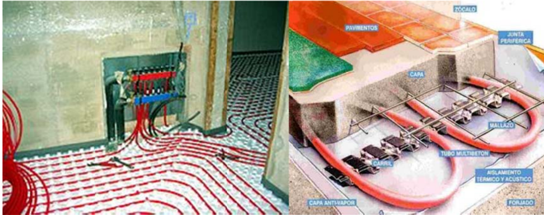
Figura 73. Instalación de las conducciones: contrapiso radiante en soporte especial a la izquierda y losa estructural radiante a la derecha.
