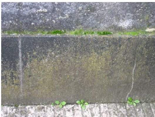
Figura 21. Biodeterioro químico. Pátinas verdes en zócalo de un muro lateral.
