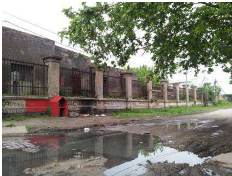
Figura 32. Foto donde se puede apreciar los tres elementos de la imagen ambiental. Estructura ferroviaria que actúa como límite entre la zona portuaria y al frigorífico, y los espacios residenciales (espacio híbrido). Año 2011.
