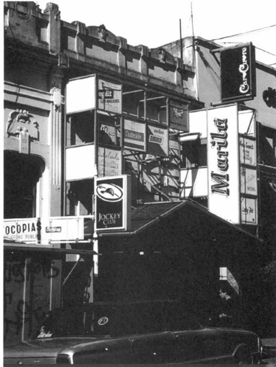
Calle 8 entre 45 y 46. Destrucción de la fachada original por la superposición de publicidad y estructuras metálicas
