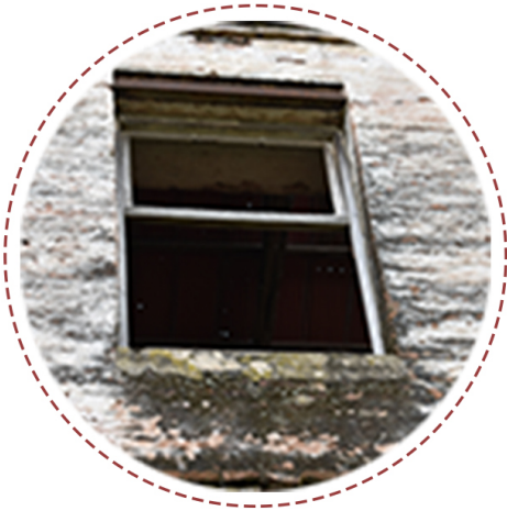
CARPINTERIA DE MADERA EN ESTADO DE RUINA
