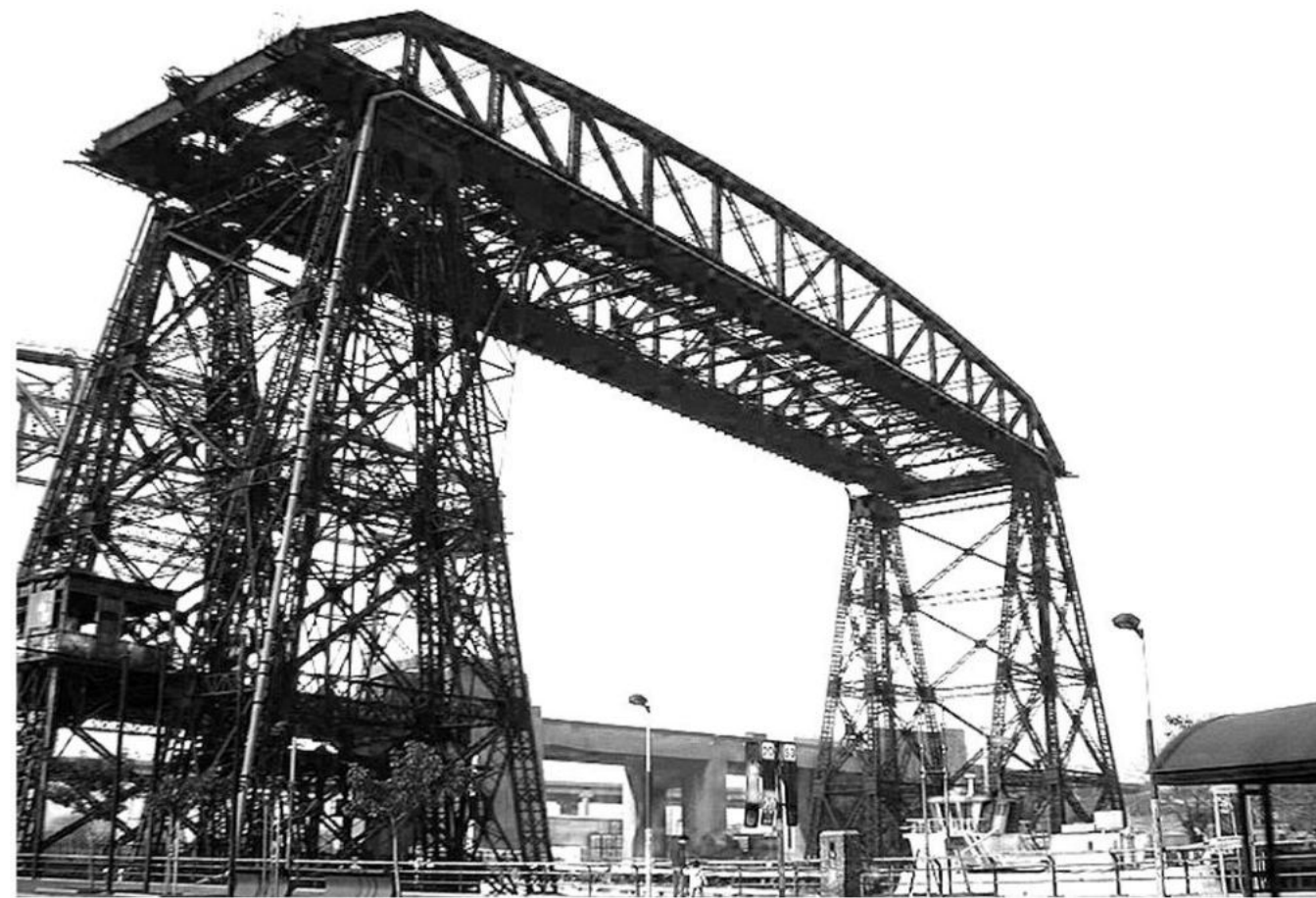
Puente Transbordador Nicolás Avellaneda, barrio de la Boca, en la Ciudad Autónoma de Buenos Aires. Su estructura de hierro fue inaugurada en 1914 cruzando el Riachuelo para unir con la zona sur del Gran Buenos Aires.
