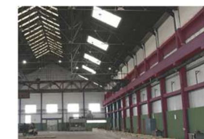
ESTRUCTURA Las columnas, vigas y fundaciones son de hormigón armado con estructura para puentes grúas.
