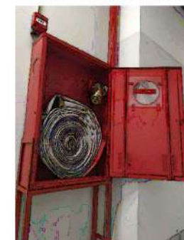
BOCA DE INCENDIO EQUIPADA
