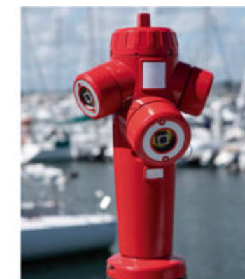
Boca de conexión para servicio de bomberos
