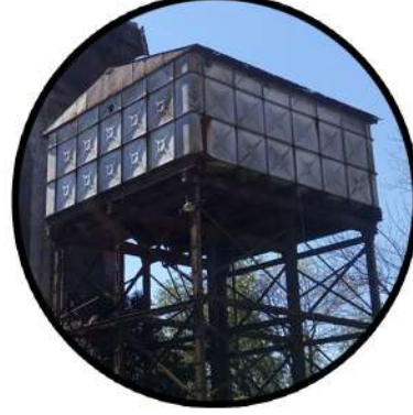
3. Tanque de agua
