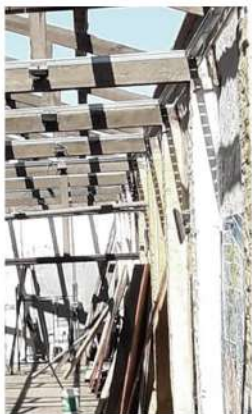
Ausencia de la cubierta de chapa
