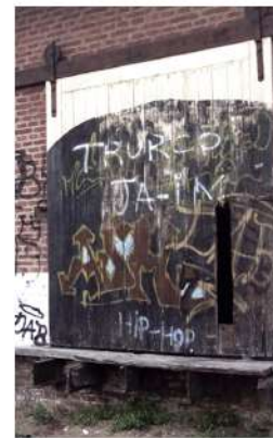
Deterioro de las carpinterías
