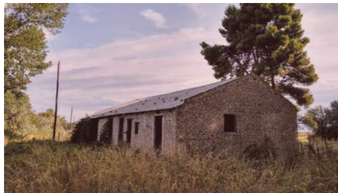
04 La lechería (LMQ) 1942.- Pequeño edificio de ladrillo macizo y cubierta de chapa, hoy en día en desuso, es un hito, un punto de referencia en el camino costero.
