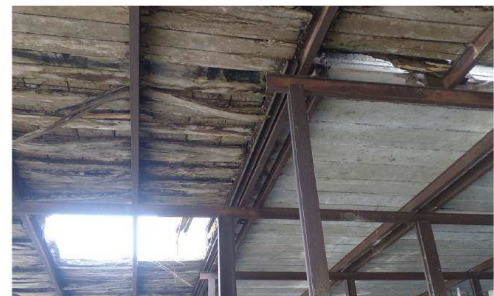
Limite entre la plataforma de madera y hormigon
