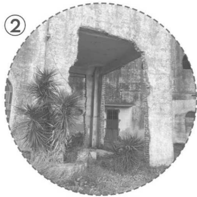
② -ENVOLVENTE- Paredes descontruidas y en mal estado
