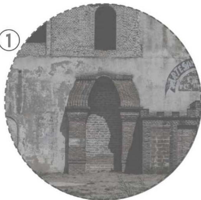
-PUERTA DE ACCESO- Tapiada con ladrillos bloqueado el acceso
