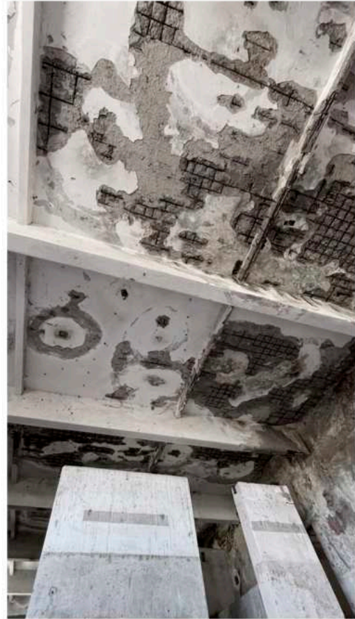
DESPRENDIMIENTO DE LOSA
