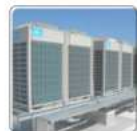
Unidad condensadora exterior.
