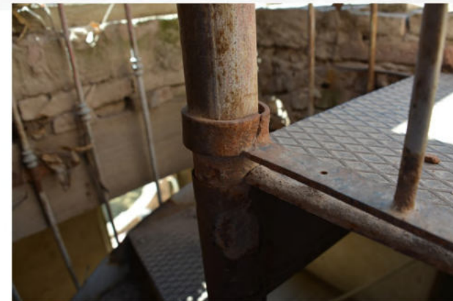
④ Oxidación y corrosión en escalera metálica.
