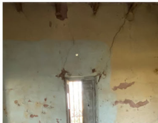
② Grietas desde carpintería hacia la cubierta por fallas en las fundaciones.
