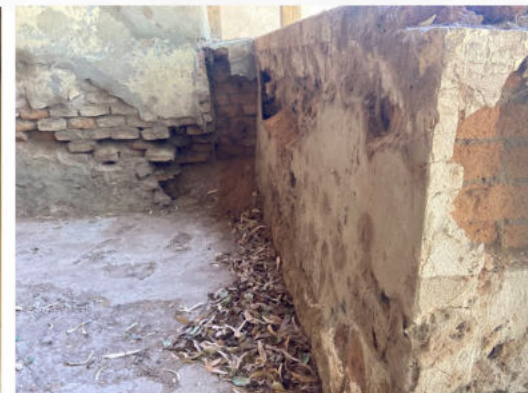
③ Revoque deteriorado, en malas condiciones, desprendido a causa de la presencia de humedad.
