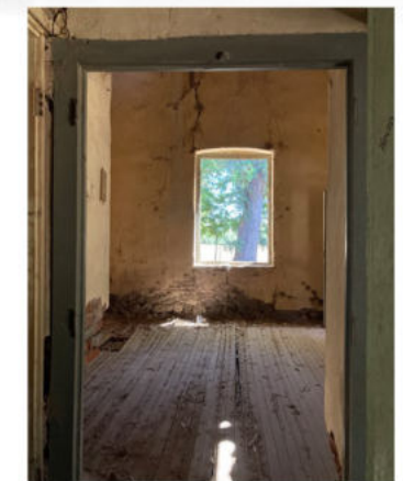
⑤ Fisuras en muro portante. Desprendimiento de revoque en muro vinculado al suelo por la ascendencia de humedad.
