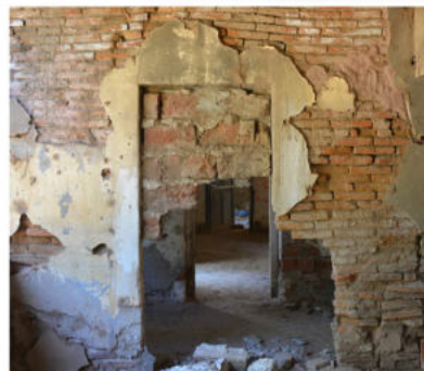
① Vano semi clausurado, desprendimiento de revoque por exposición a la intemperie.
