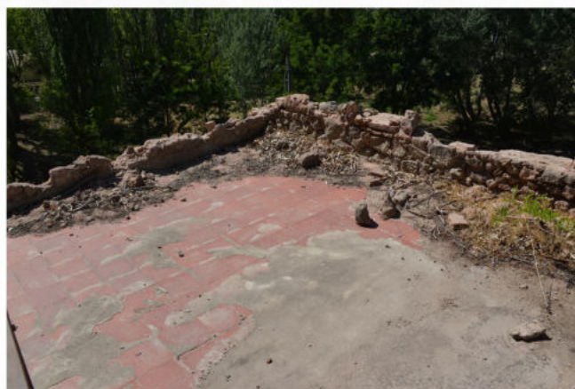
① Desprendimiento de cornisa contenedora de terraza.
