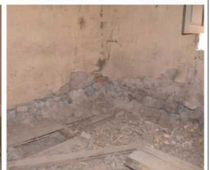
⑧ Ausencia de revoque en el inferior del muro. Fisuras con filtración de humedad.
