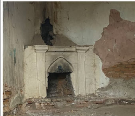
① Desprendimiento de pintura, superficie quemada a causa del vandalismo.
