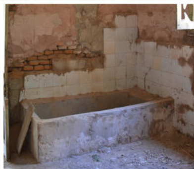
② Azulejos originales presentes, con faltante de piezas por desprendimiento.
