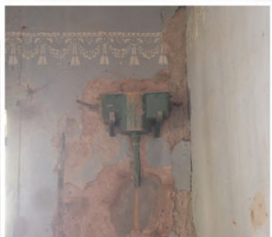
③ Restos de antigua instalación sanitaria obsoleta, en mal estado.
