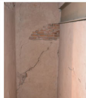
⑤ Grietas en la vinculación de la escalera con la torre.
