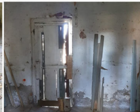
⑤ Presencia de humedad, carpinterías en mal estado.
