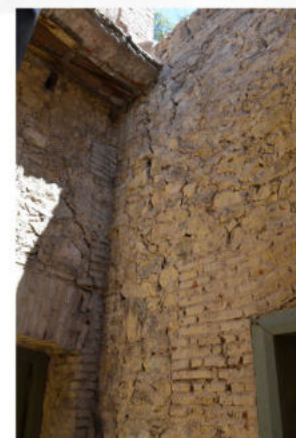
③ Presencia de grietas en muros portantes de la torre.
