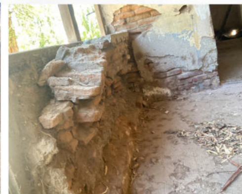
④ Desprendimiento de revoque y derrumbe de muro.
