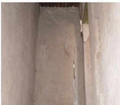
④ Grietas mayores en sentido vertical presentando riesgo de separación de la torre.
