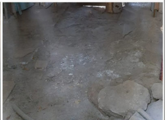
⑥ Humedad presente Contrapiso deteriorado.
