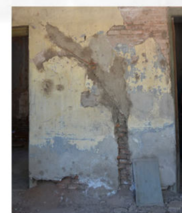
④ Suciedad, presencia de hume- dad, grietas, desgaste en muros, desprendimiento de revocos Rastro de reparación de superfi- cies.
