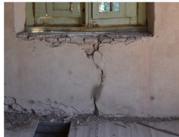
② Desprendimiento de revocos por humedad. Grieta hacia abajo debido a una mala repartición en las fundaciones.
