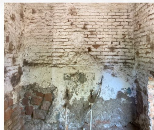
② Instalación de agua antigua, obsoleta y en desuso. Presencia de humedad Desprendimiento de revoques.
