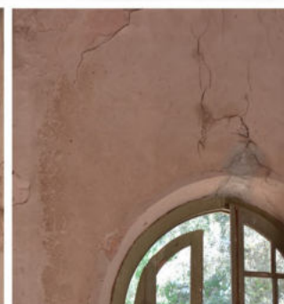
⑦ Filtraciones provenientes del techo y grietas verticales hacia la carpintería.
