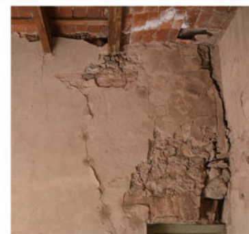
⑥ Falta de traba de ladrillos en esquina. Desprendimiento de revoques.
